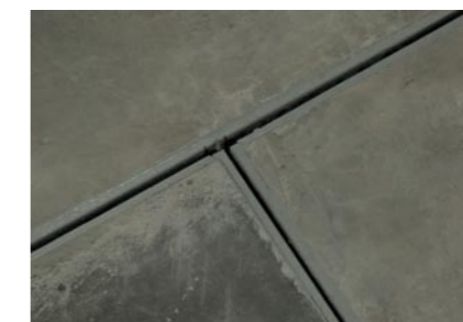
Fot. 2. Przesunięcie krawędzi dylatacji konstrukcyjnej
